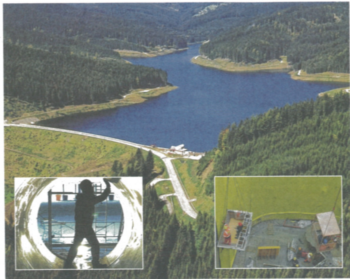
Auf Hochtouren wird am Kraftwerk gearbeitet (kleine Fotos). Ende 2010 soll der Stausee entleert werden KELAG BILDARCHIV (3)
