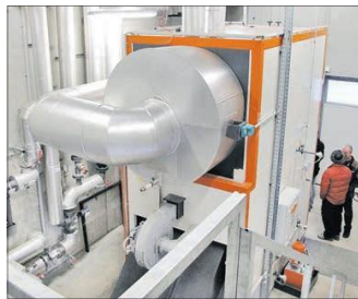
Blick in das Innere der Biomasse-Nahwärmeanlage.
