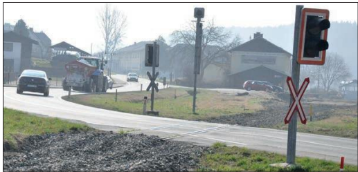
Ein für die Gemeinde Lavamünd sehr interessanter Bereich ist das Areal rund um den ehemaligen Bahnhof Lavamünd. Dort soll der Boden aber durch Mineralöl stark kontaminiert sein, wie in der GR-Sitzung zu hören war. Foto: UNI/Archiv
