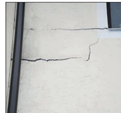
Auf der Rückseite des Rüsthauses sind tiefe Risse im Gemäuer.
