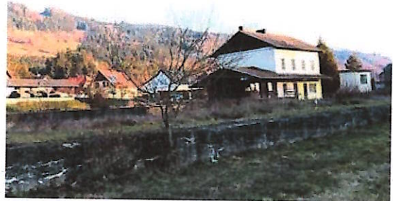
Von den Stützmauern am ehemaligen Bahnhofsgelände in Lavamünd geht aber noch eine Gefahr aus. © (c) Rosina Katz-Logar
